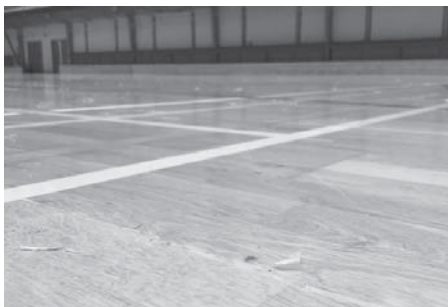
Poškozený povrch haly Městské sportovní haly bude do prázdnin opraven.
